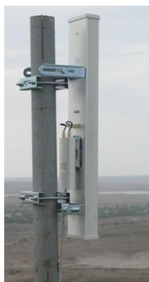
Рис. 8. Точка доступа центра беспроводной сети связи СССМ
