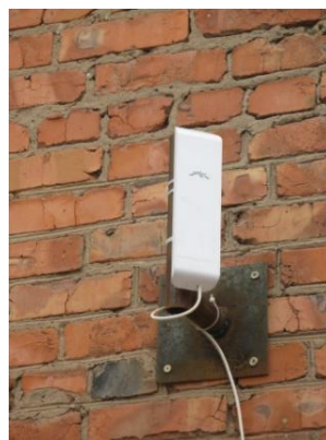
Рис. 9. Клиентская станция сети связи СССМ для средних расстояний
